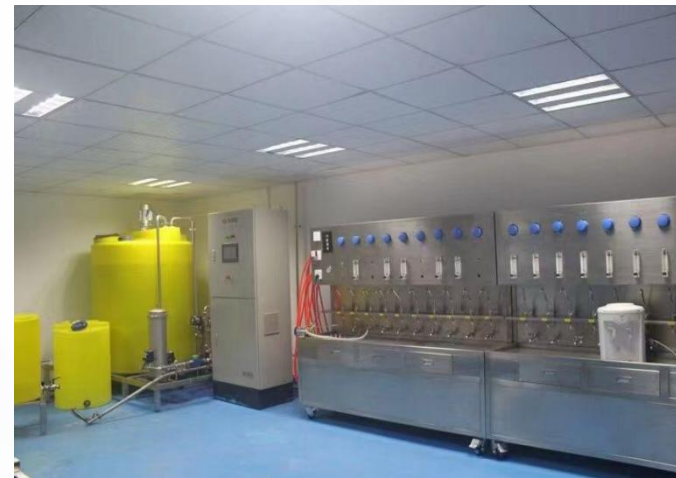
净水设备检测台
